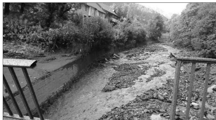
■ Le pont de Lachal : garde-corps arrachés, digues submergées.
